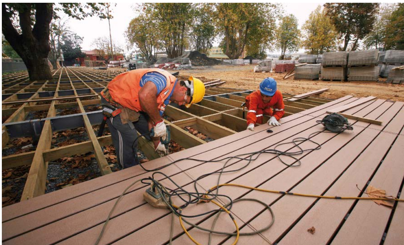
El presidente local del comité de Arquitectura y Urbanismo es coautor del proyecto de remodelación de la Plaza de Penco, actualmente en ejecución.
